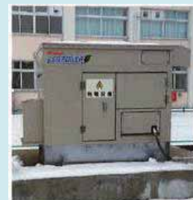
非常用発電機
